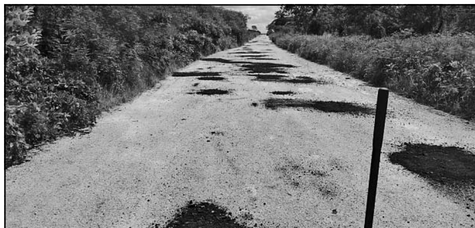
Al menos ya pueden circular por el tramo que estaba cubierto de huecos. (POR ESTO!)
