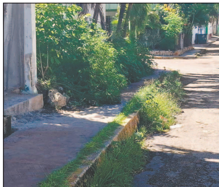
La obstrucción obliga a los transeúntes a caminar sobre la calle. (E. Cauch)
