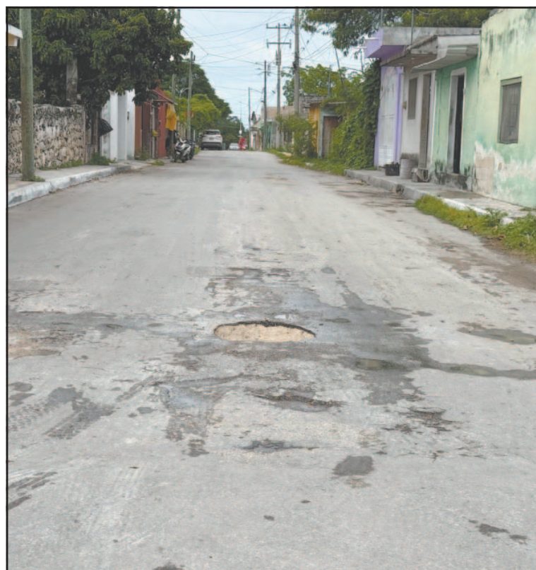
Alertan sobre el riesgo de accidentes en el cruce de las calles 24 y 21.
