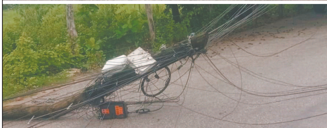
Vientos y líquido acumulado en los techos causaron el desplome de infraestructura en la Riviera Maya.
