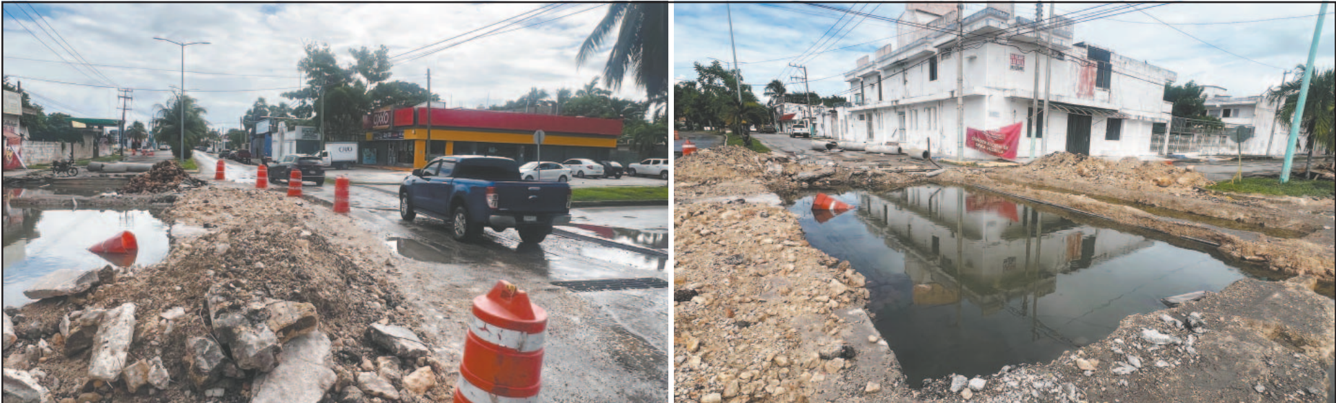
La rehabilitación de alcantarillas en el cruce de las calles Manuel M. Diéguez y López Velarde apenas comenzó; mientras, algunas cunetas ya parecen “albercas”. (E. Martín)
