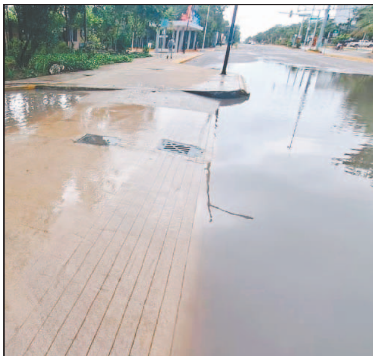
La posición de la alcantarilla impide que el agua se drene. (E. Silva)
