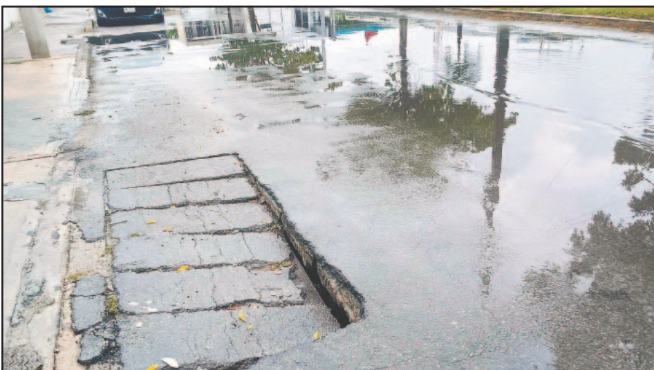
El agua provocó el reblandecimiento en la calle Chicozapote, entre Dos Aguadas y Chablé.
