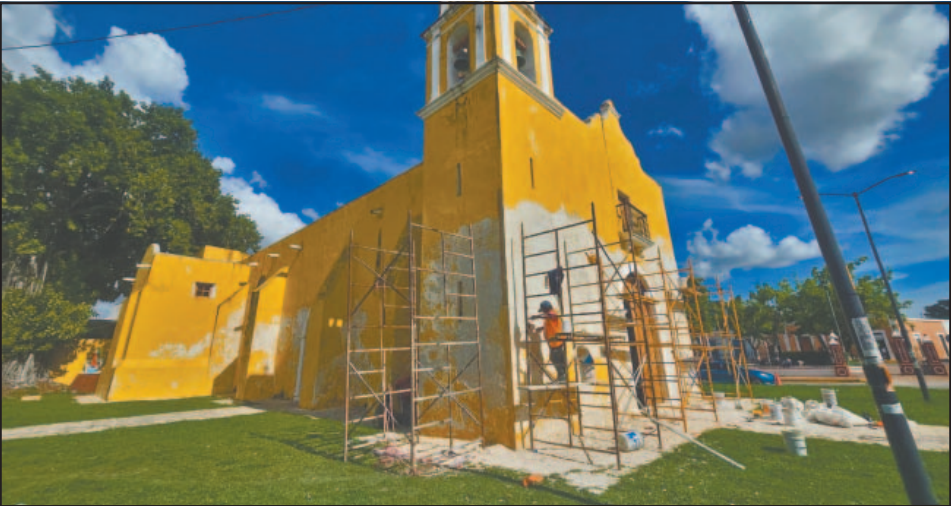
La estructura registró el desprendimiento de una cruz tras el impacto de un rayo. (A. Pech)
