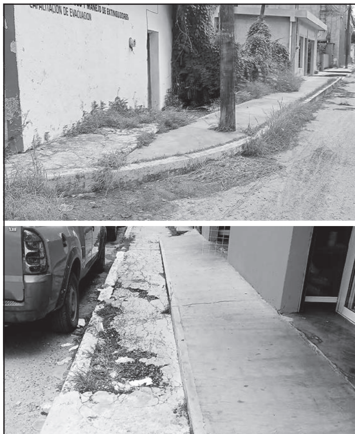
Las escarpas deterioradas son un peligro para los peatones. (E. Cauich)
