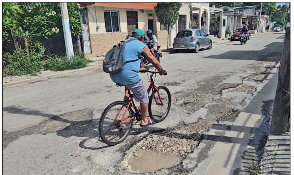
Habitantes aseguran que los trabajos de reparación realizados anteriormente resultan insuficientes.
