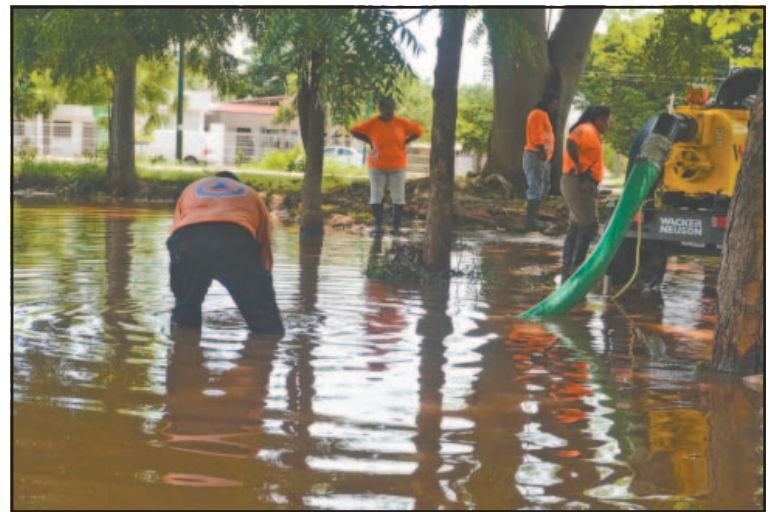
Zonas bajas estarán expuestas a encharcamientos e inundaciones.
