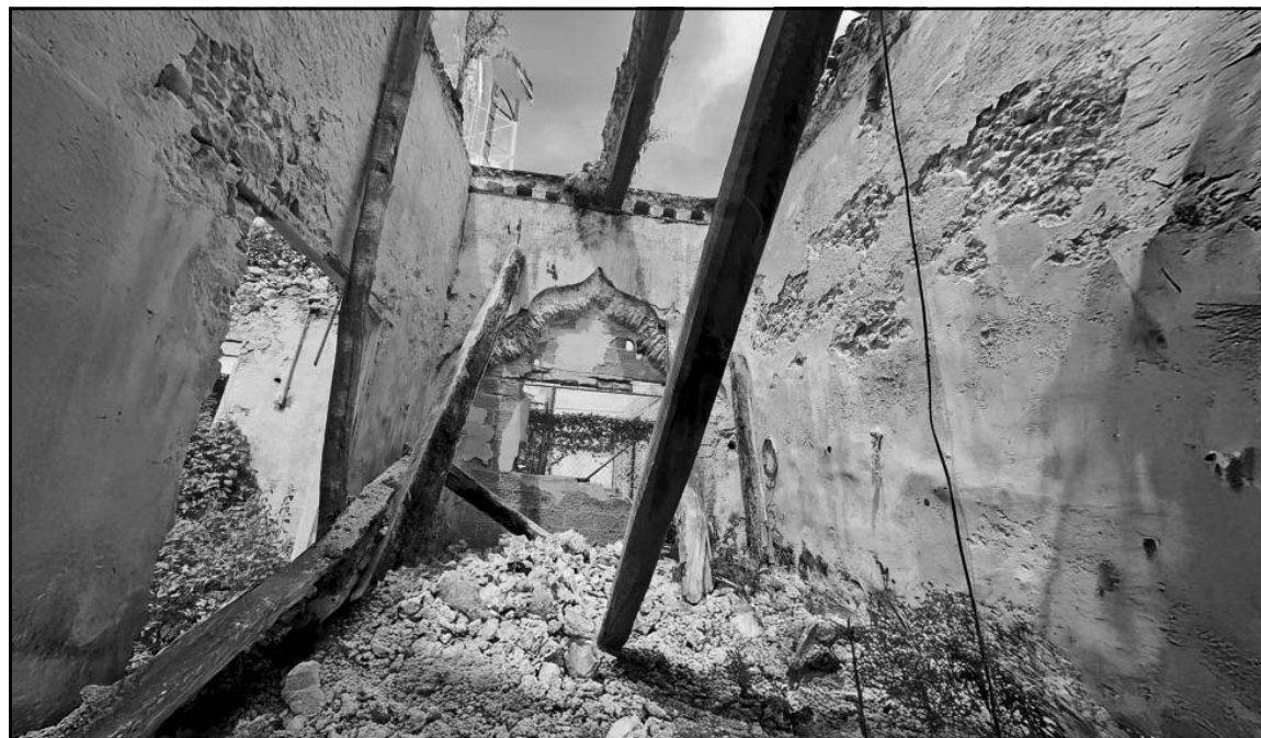
El derrumbe de la estructura evidenció el deterioro de las paredes por el paso del tiempo. (D. Herrera)
