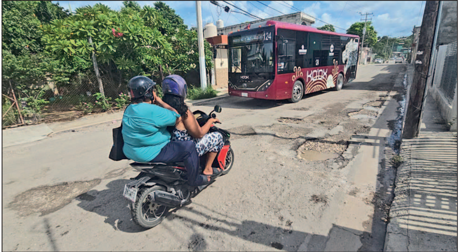
El deterioro se ha acentuado con las precipitaciones recientes, situación que dificulta el tránsito cotidiano de familias y conductores.
