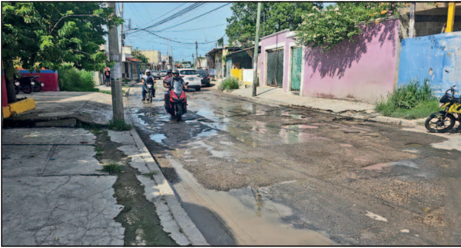
Motociclistas enfrentan riesgo de derrapes entre los desperfectos. (Alejandro Pech)
