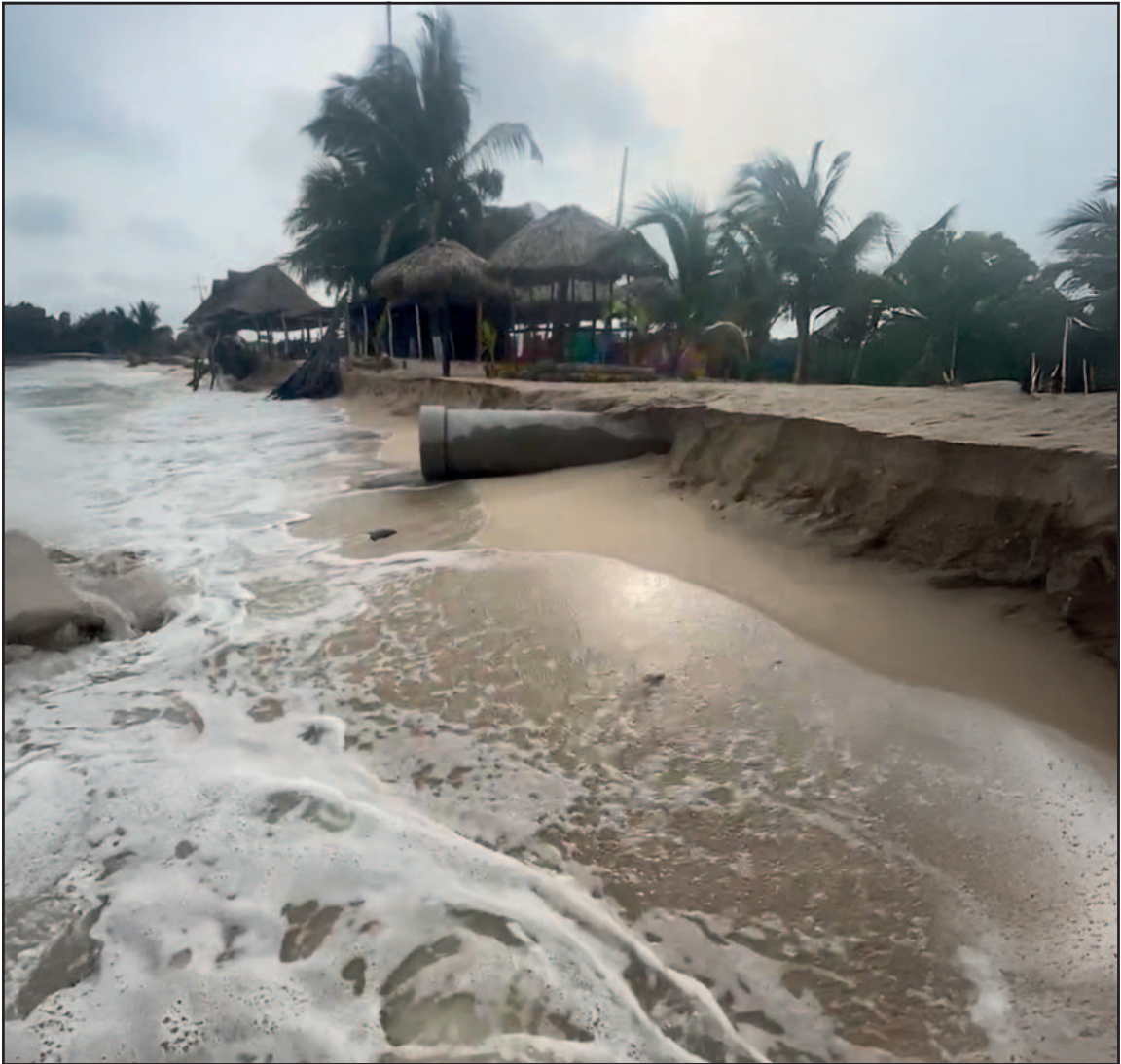
La erosión dejó expuestos ductos de desagüe que desembocan directamente al mar. (POR ESTO!)
