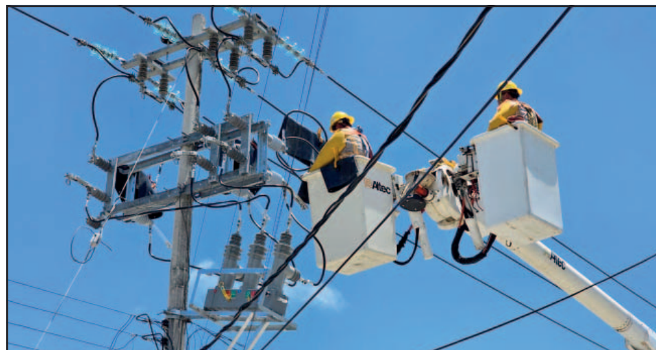
La reposición del suministro puede tardar más de cinco horas después de una falla.
