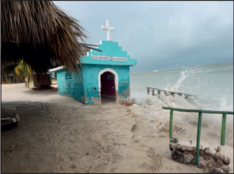
Una capilla ubicada junto a la costa sufrió afectaciones por el agua.
