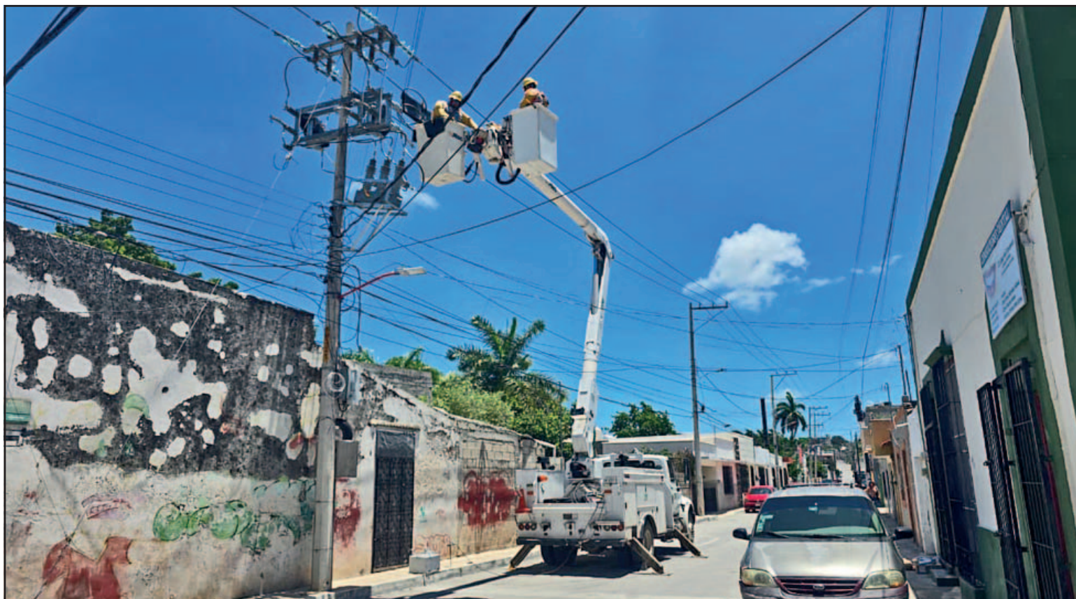
Transformadores averiados han provocado extensos periodos de suspensión en el suministro, con pérdidas económicas para los usuarios.
