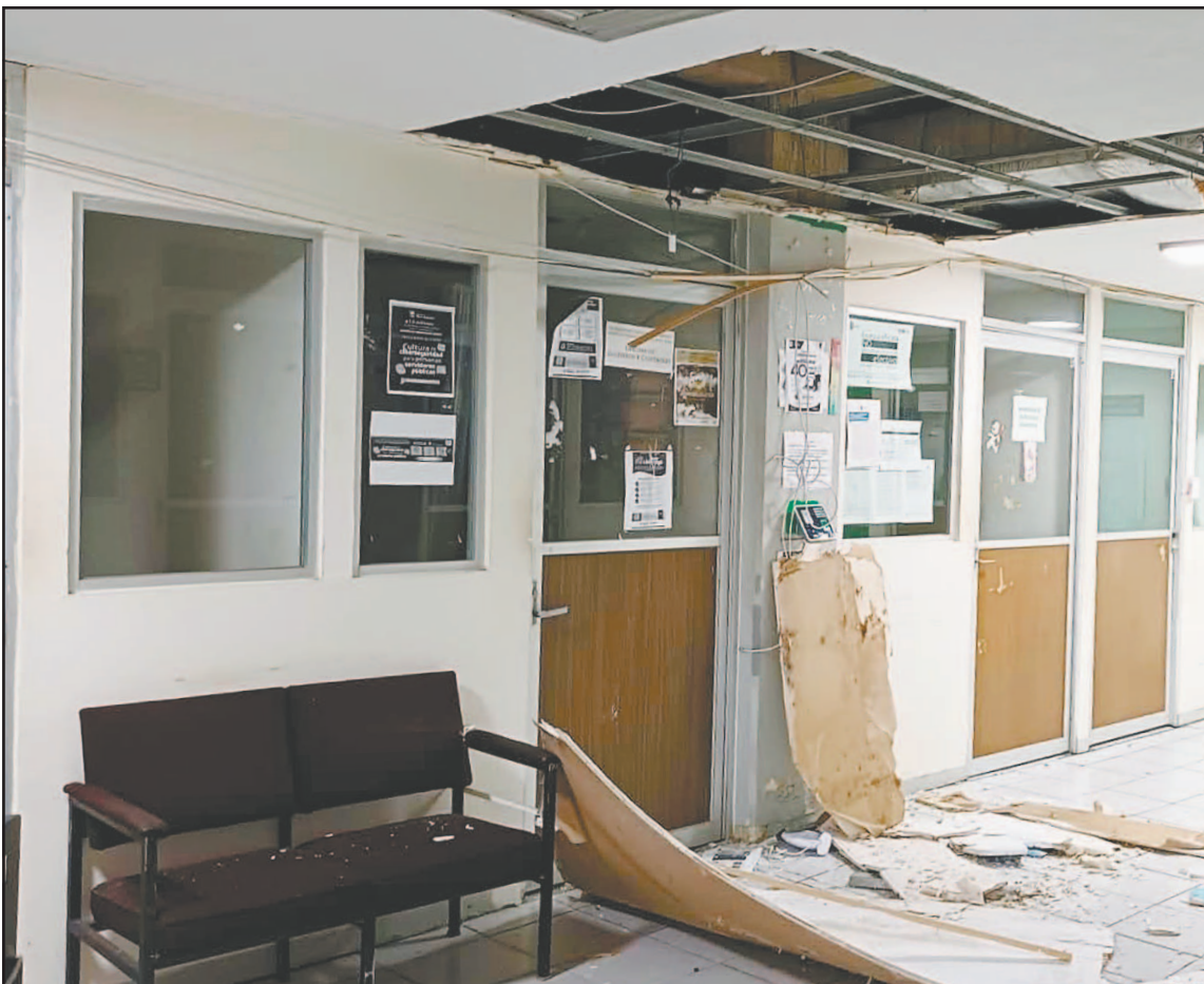
Quejosos señalaron el deterioro del inmueble, mientras que el director atribuyó daños en el techo a las lluvias.
