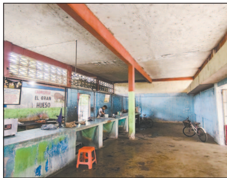
El inmueble luce deteriorado y hay filtraciones en el techo. (L. Kauil)
