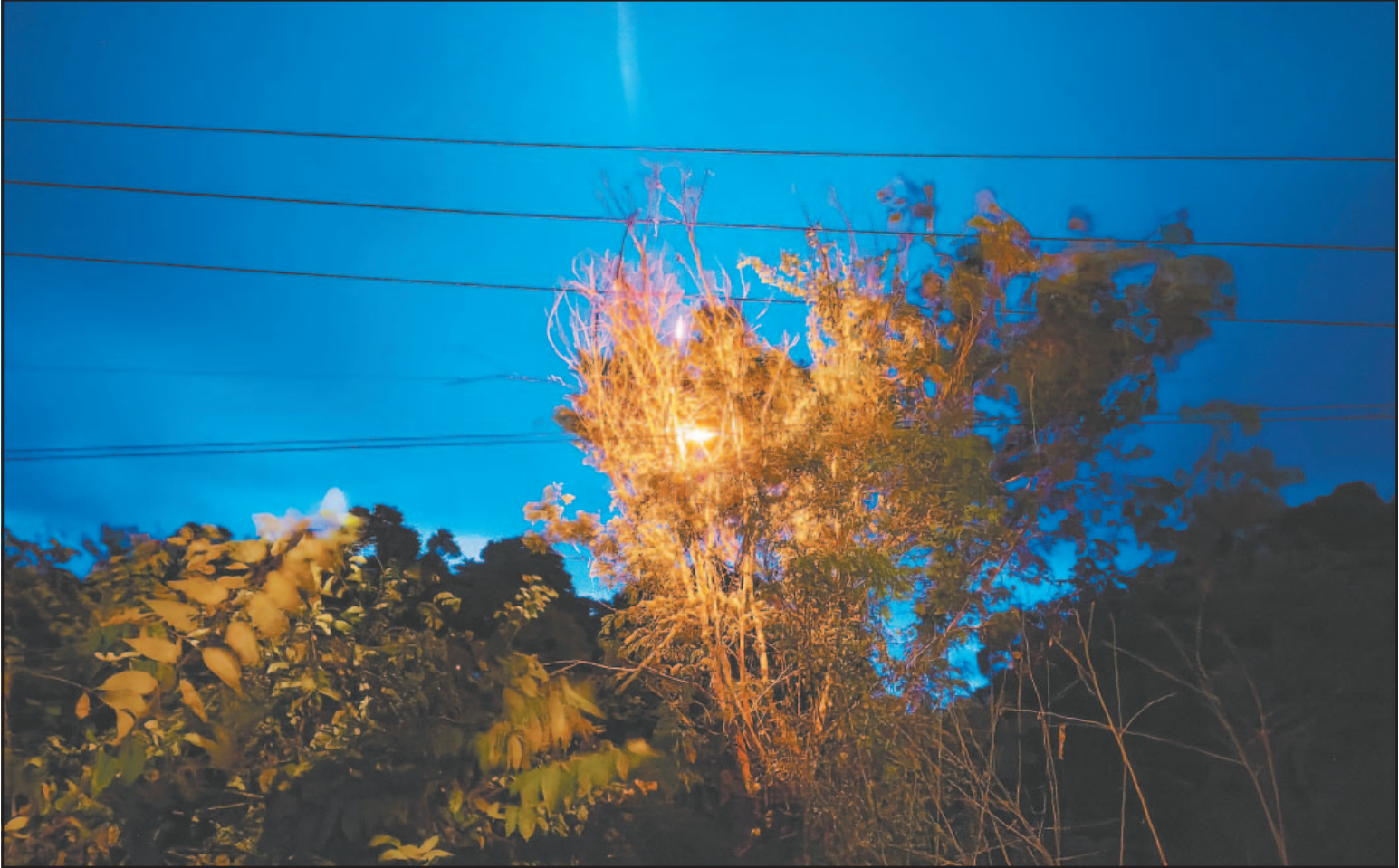
Señalaron que las rachas de viento podrían agravar las fallas y ocasionar una interrupción en suministro hacia las viviendas. (J. Xiu Chan)
