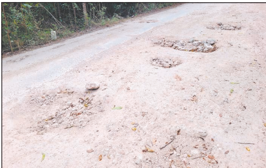
Varios tramos fueron nivelados de manera provisional con sascab por los habitantes.
