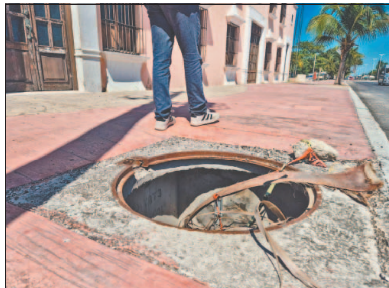
Diversos transeúntes exigen que la CFE tape el registro. (Jorge M.)
