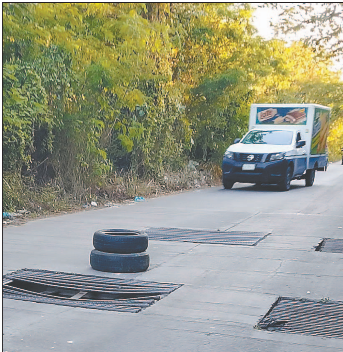
Un habitante colocó par de llantas para que los conductores puedan ver el peligro. (Williams Duran)
