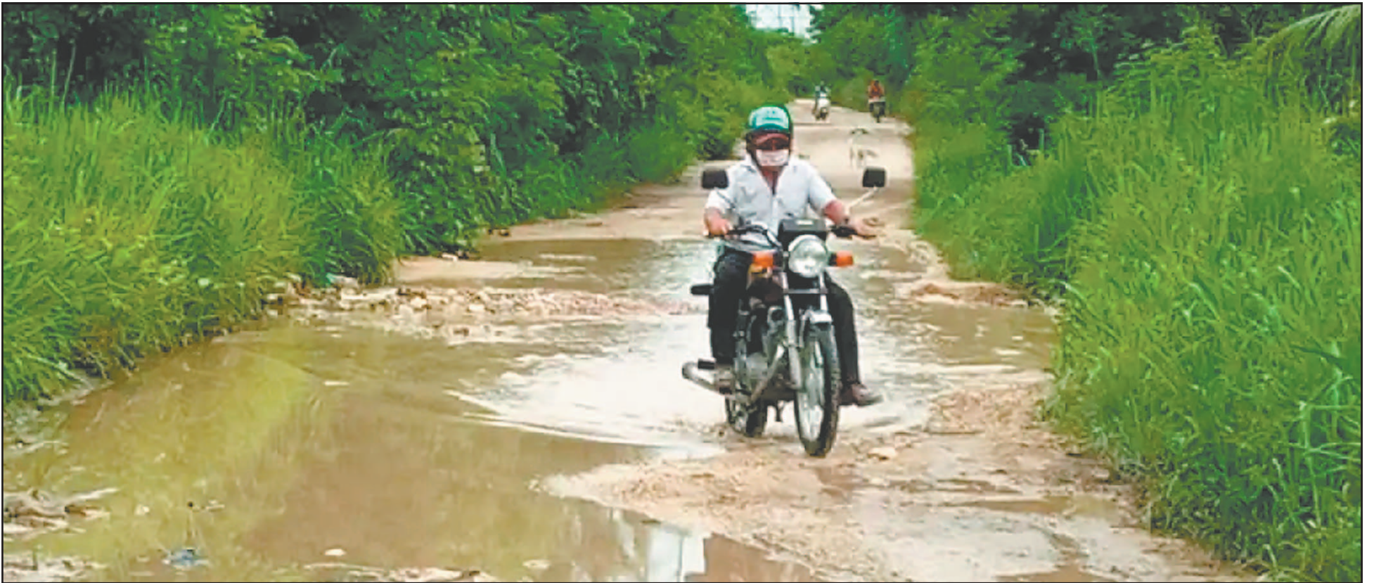
Ciudadanos señalaron las malas condiciones de la infraestructura, las cuales reflejan deterioro de vialidades y presencia de baches; exigieron conceptos específicos del gasto. (POR ESTO!)
