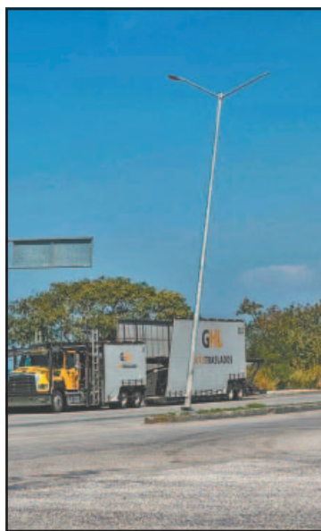
La estructura podría colapsar con el siguiente 'Norte'. (J. May)
