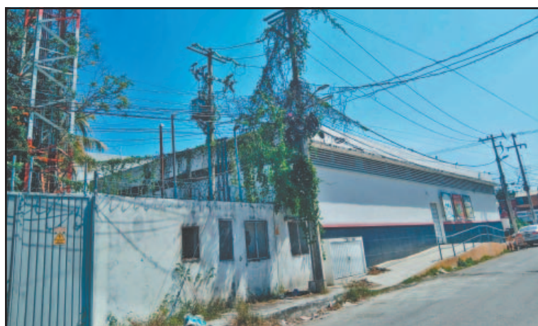
Piden que la CFE acuda a limpiar sus instalaciones. (Joaquín G.)
