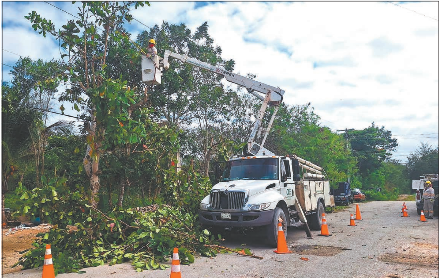
Aunque la CFE no informó sobre el origen de la falla, todo indica que es porque las ramas de los árboles golpean los cables. (Justino Xiu)
