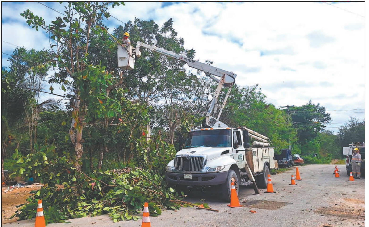
Aunque la CFE no informó sobre el origen de la falla, todo indica que es porque las ramas de los árboles golpean los cables. (Justino Xiu)
