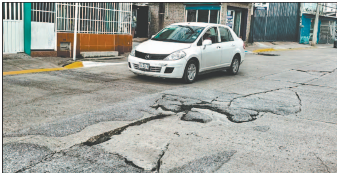
Hay cruces como en las calles 44 y 46 en donde las grietas del asfalto son "trampas" viales. (Especial)
