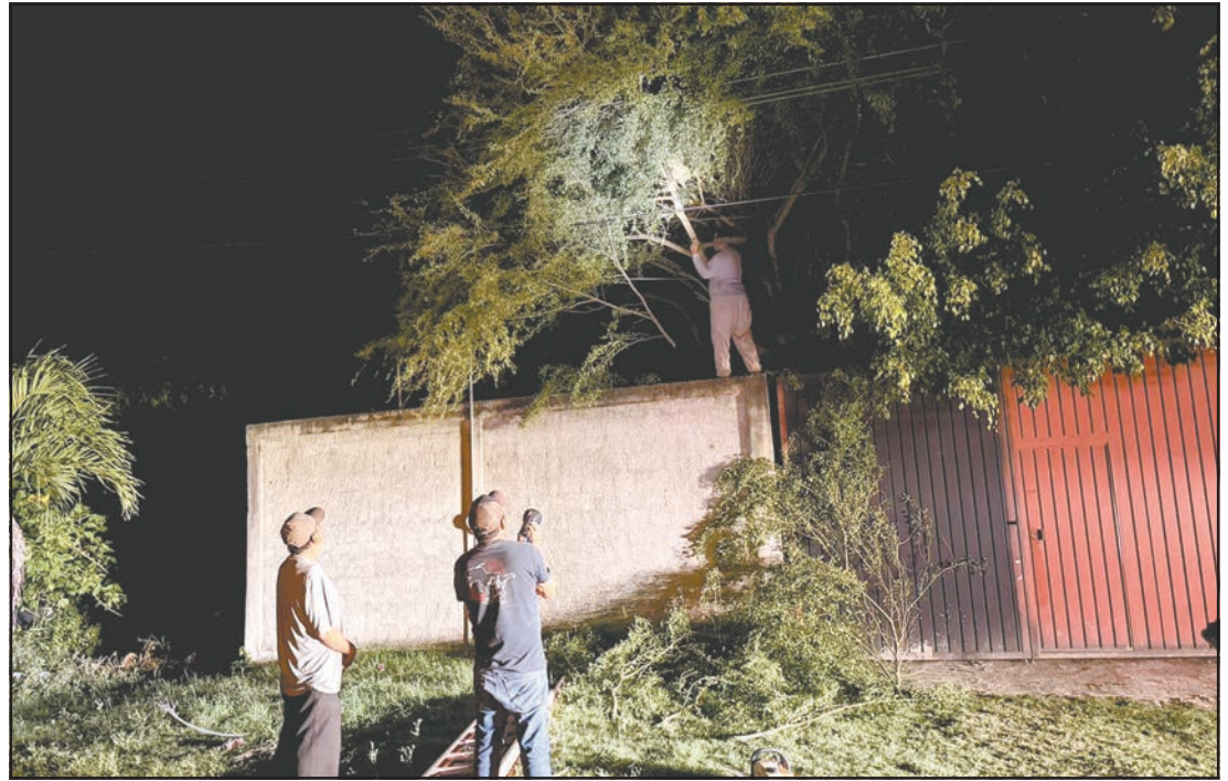
Las ramas en contacto con las líneas eléctricas causan la interrupción de la electricidad. (Fotos POR ESTO!)
