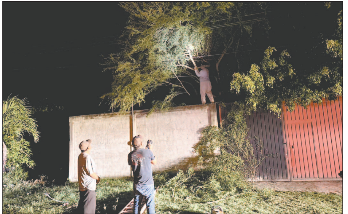
Las ramas en contacto con las líneas eléctricas causan la interrupción de la electricidad. (Fotos POR ESTO!)
