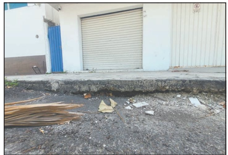
Los daños provocaron fisuras en algunas viviendas. (Aarón Bautista)
