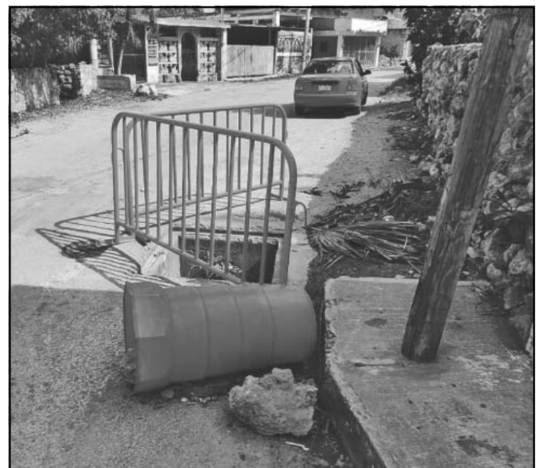
Obras Públicas colocó vallas para impedir un accidente. (E. Caamal)
