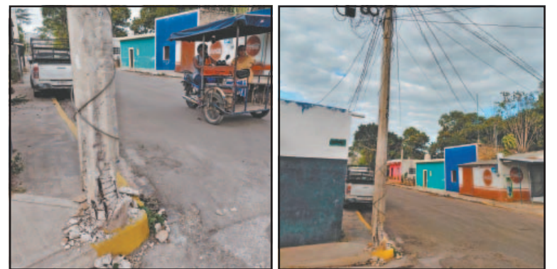
La estructura quedó averiada tras el impacto de un camión. (M. Koh)
