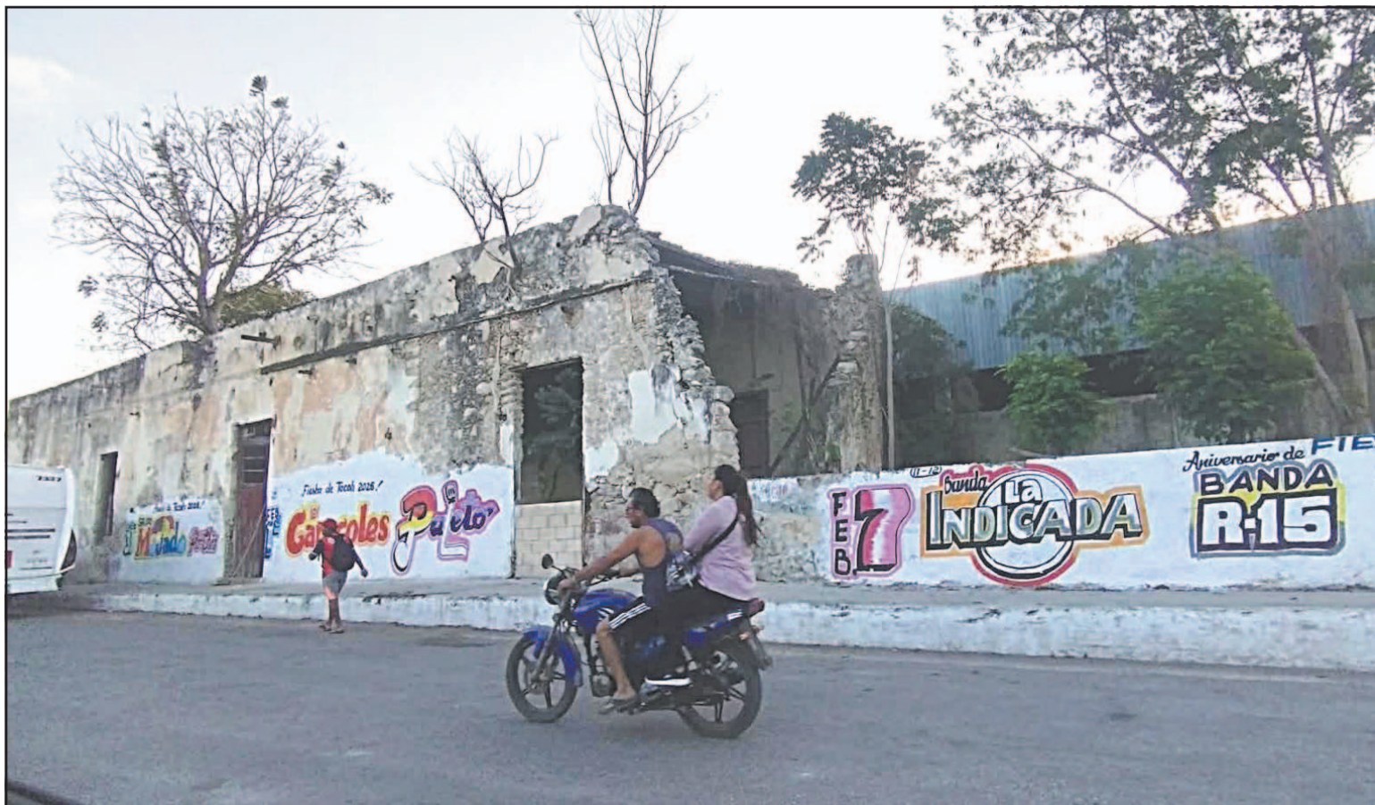
El deterioro del edificio representa un peligro real para la gente; los encargados de seguridad llegaron y pusieron cintas de aviso. (POR ESTO!)
