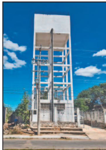
No pudieron encender las bombas.
