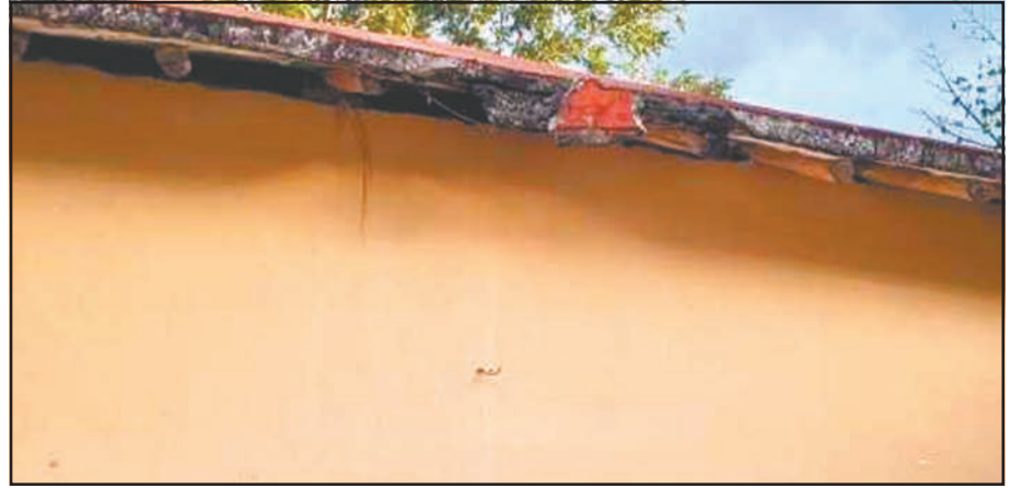
Padres exhibieron el deterioro del edificio; habilitaron otro lugar para el desayuno.
