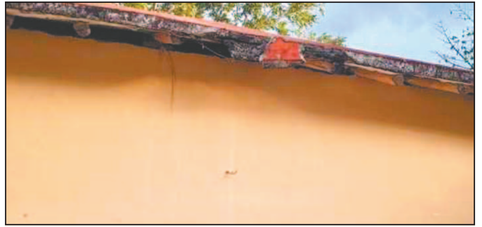
Padres exhibieron el deterioro del edificio; habilitaron otro lugar para el desayuno.
