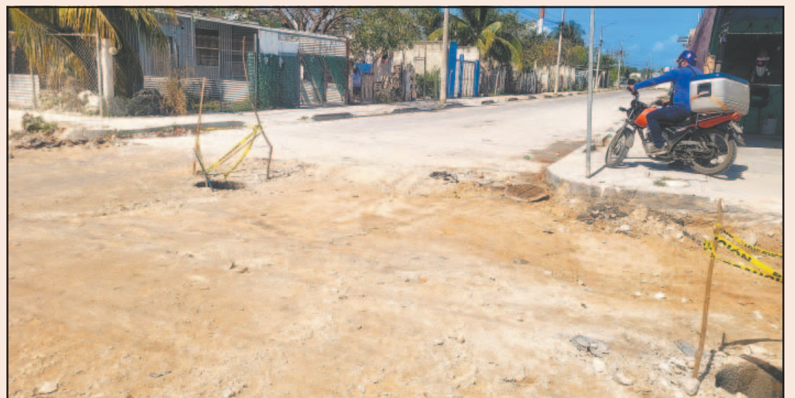
Contemplaron rejillas de captación cerca de los pozos, que tienen profundidad de 25 metros. (A. Bautista)
