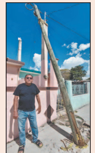
El poste quedó recargado en la columna. (M. Koh)
