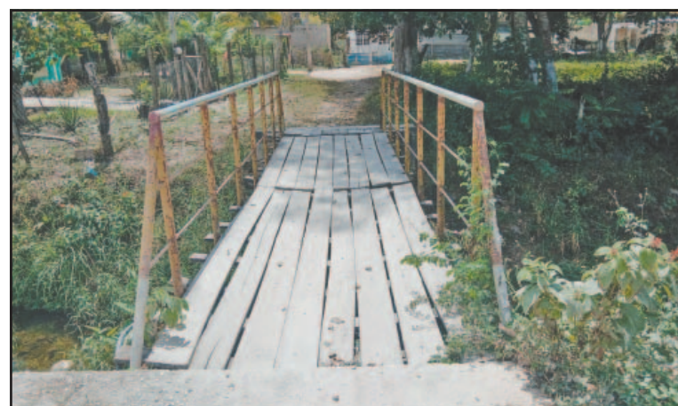
Cuando llueve es más peligroso por la humedad. (Joaquín Guevara)
