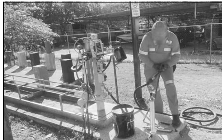
En el lugar despachaban cilindros sin medidas de seguridad. (POR ESTO!)
