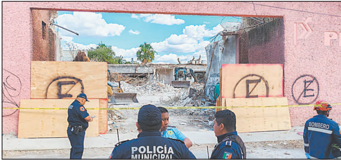
Dos alba iles se encontraban sobre la estructura superior cuando de pronto cedi  de forma s bita.
