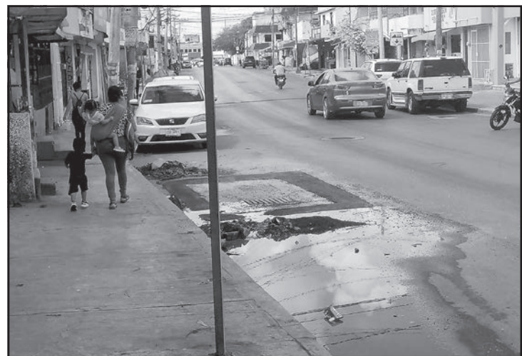
El Ayuntamiento dejó chapopote cerca de una alcantarilla. (Erick Romero)
