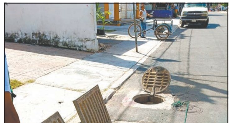
La gente indicó que el pavimento presenta desniveles. (POR ESTO!)
