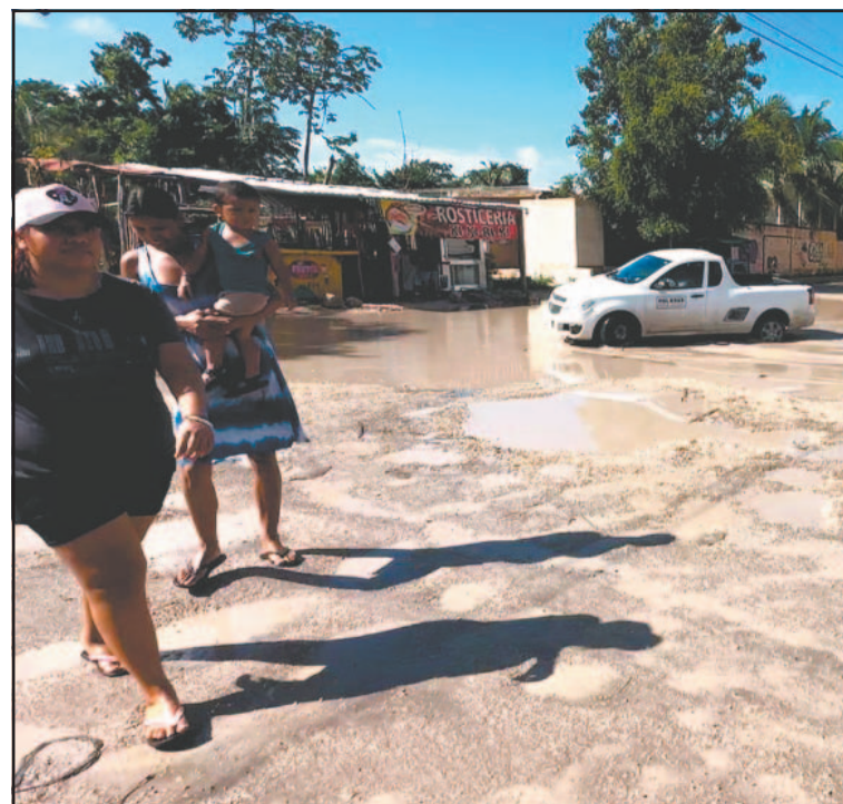
Afirmaron que en las recientes obras ya surgieron huecos. (POR ESTO!)
