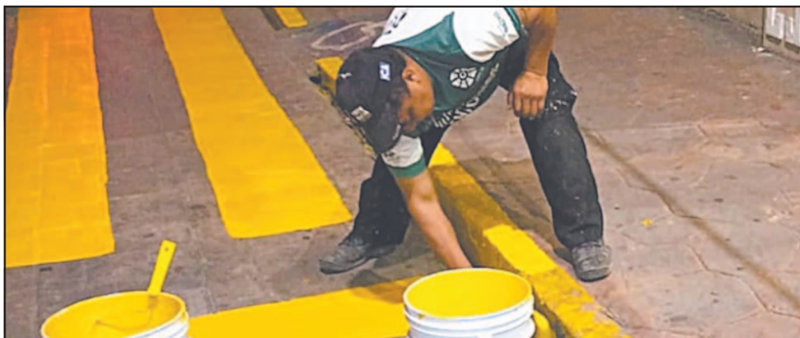
Se llevaron a cabo trabajos de rehabilitación de señalética en distintos puntos de la ciudad. (A. Osorio)
