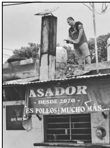
Un sobrecalentamiento en el área de cocina originó el fuego.
