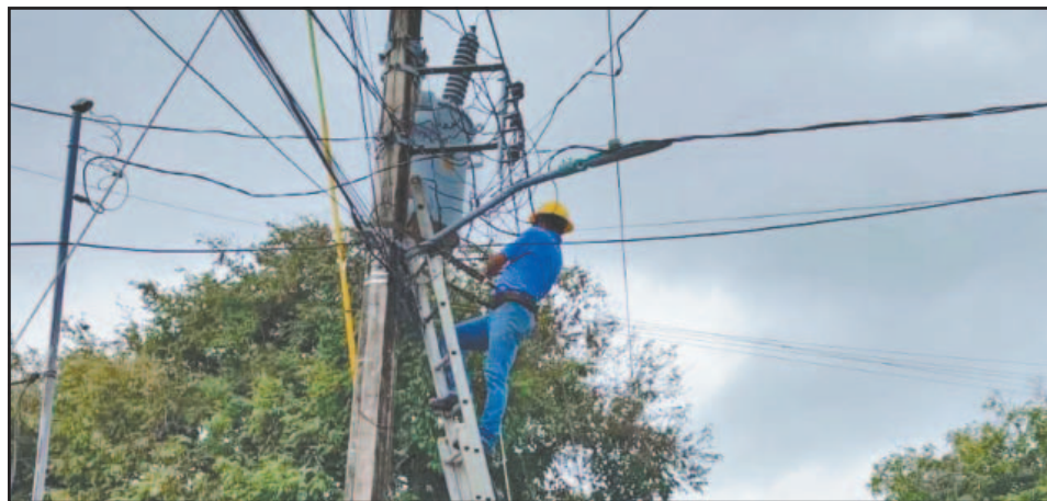
Nuevamente los pobladores exigieron que se cambie el tendido eléctrico. (Pedro Díaz)
