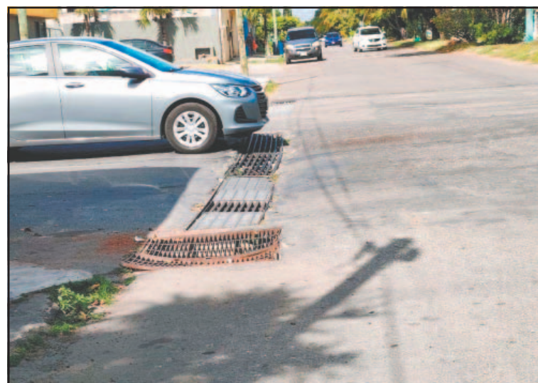
Vecinos pidieron a la Múncipe rehabilitar rejillas de drenaje. (POR ESTO!)
