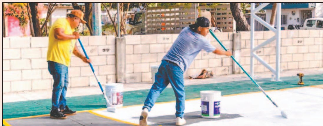
Habitantes de la colonia Huracanes señalaron deterioro en este espacio deportivo. (POR ESTO!)
