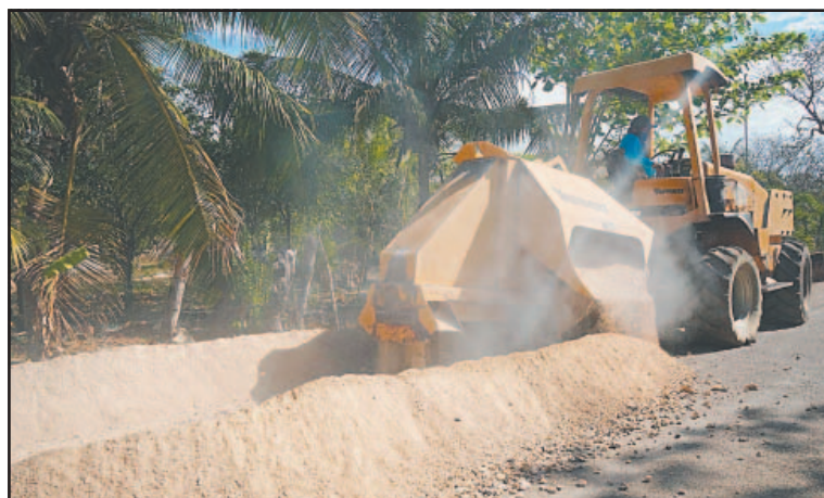
Se busca que las labores ayuden a subir la presión en las tuberías.
