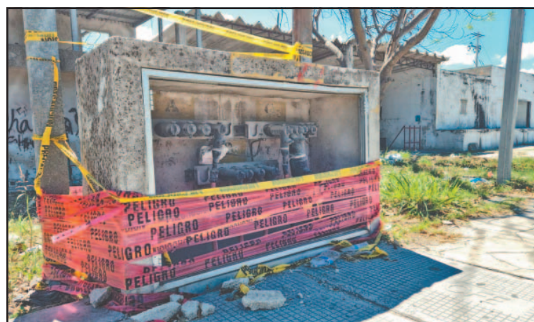
Es un real peligro ya que aún puede generar electricidad. (J. May)
