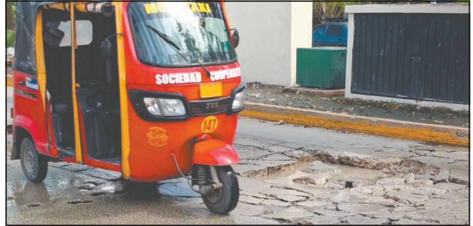
La humedad permanente hizo mella en zonas altamente transitadas por mototaxistas.
