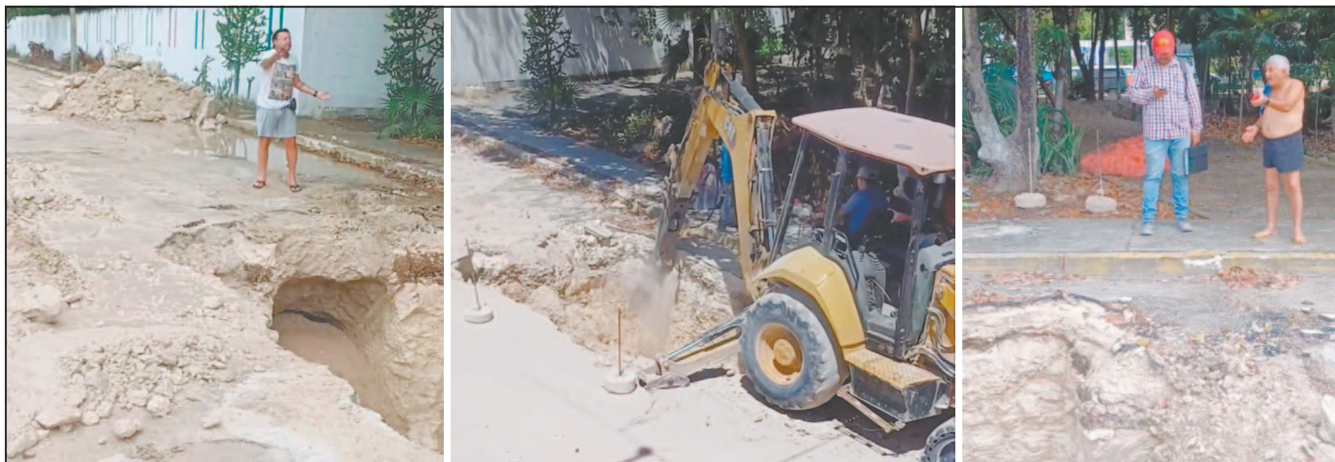
Residentes indicaron que la excavación para el mantenimiento de las tuberías es necesaria, pero mal ejecutada, pues afecta la movilidad hacia un parque y kínder. (Fotos POR ESTO!)
