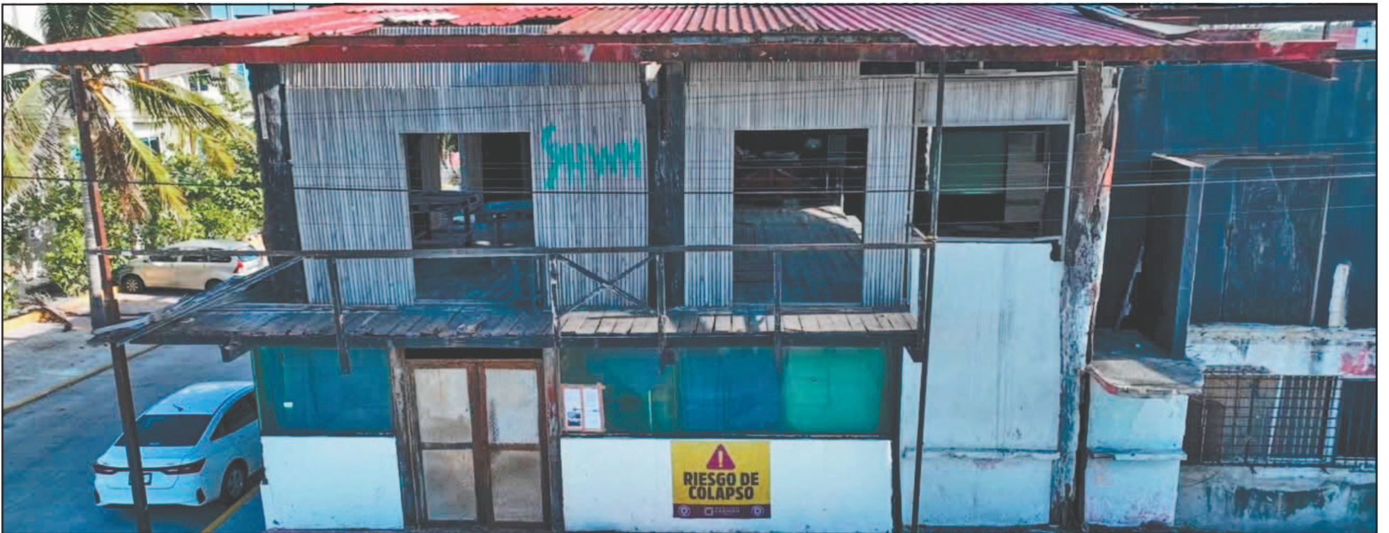
Los vecinos dijeron que a simple vista se puede apreciar el gran deterioro del recinto debido a la ausencia de mantenimiento y el material con que fue construido. (P. Prado)
