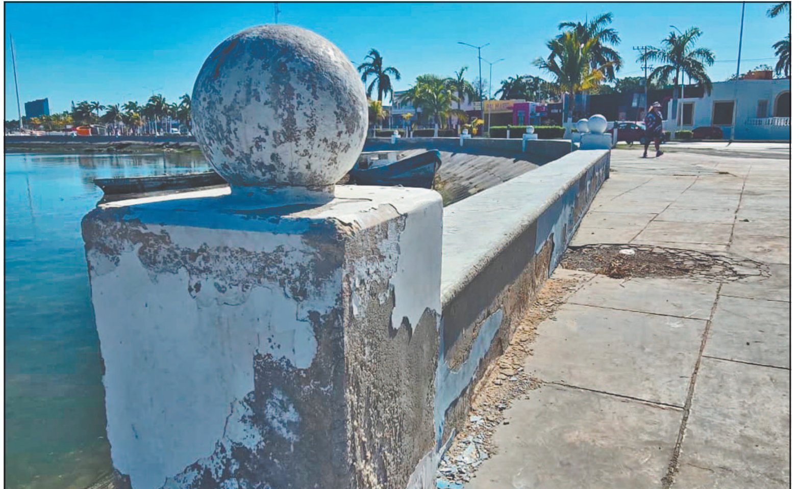
La parte más dañada es la denominada zona antigua, en donde destaca que 160 de los 350 bolardos se hallan destruidos. (Alejandro Pech)
