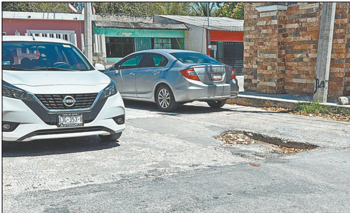
Algunos conductores refieren haber caído dentro ante la falta de señaléticas de advertencia. (Jorge M.)
