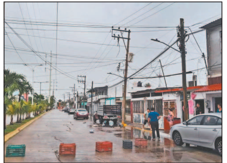
Sobre la avenida 10 de Julio explotó un transformador de la CFE.
