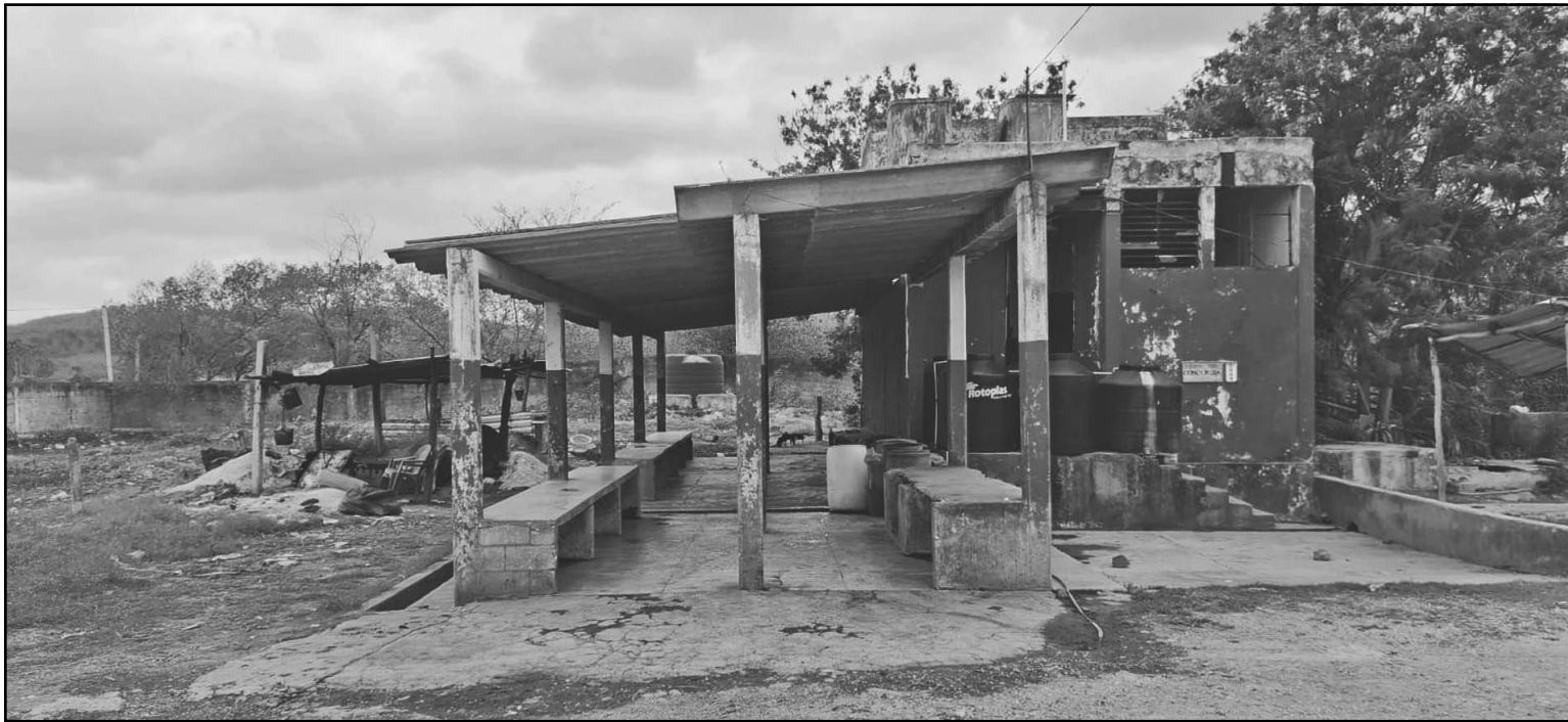
El matadero perteneciente a Hechelchakán se cae a pedazos; los corrales no sirven y las mesas de sacrificio están deterioradas. (A. Caamal)
