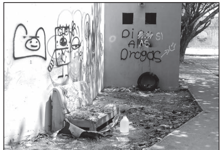
El sitio de esparcimiento de Paseos Kabah fue vandalizado. (E. Romero)
