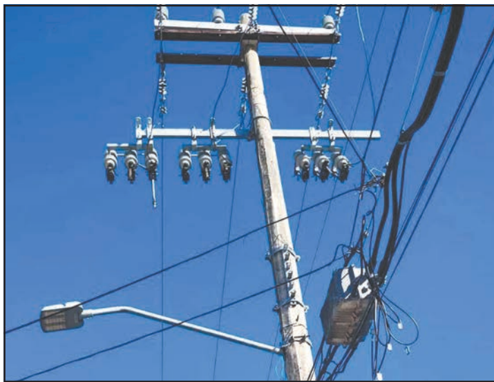
Quejosos dijeron que la infraestructura eléctrica lleva años sin atención.
