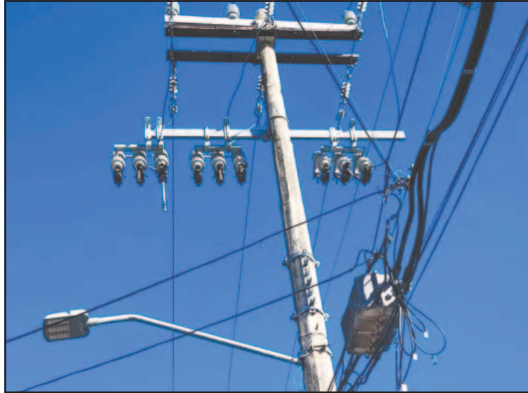
Quejosos dijeron que la infraestructura eléctrica lleva años sin atención.
