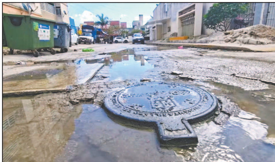
Aguakan culpó a la CFE de los desperfectos en sus plantas potabilizadoras y cárcamos.
