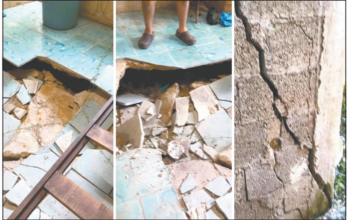
Personal de la Coordinación Estatal de Protección Civil determinó que las casas deben ser demolidas.
