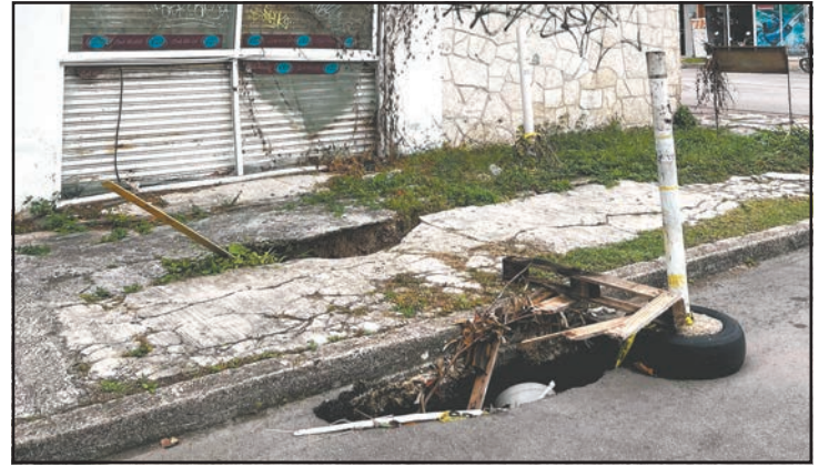
En las calles y banquetas se observan los hoyancos. (Fotos E. Martín)
