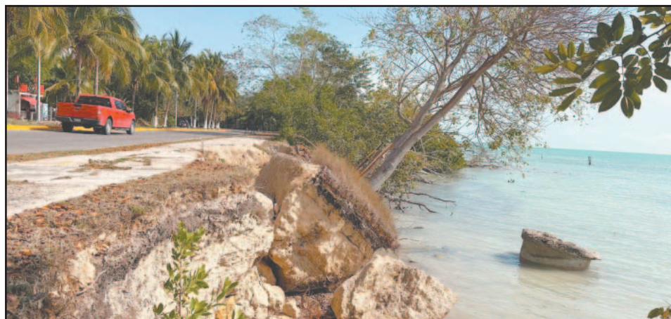
Desgaste progresivo redujo la franja de resguardo entre el área afectada y la banqueta.
