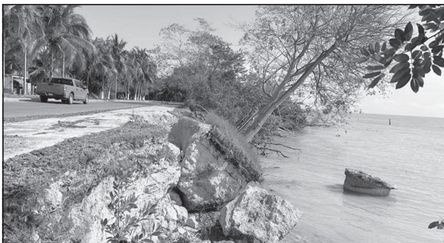
Desgaste progresivo redujo la franja de resguardo entre el área afectada y la banqueta.
