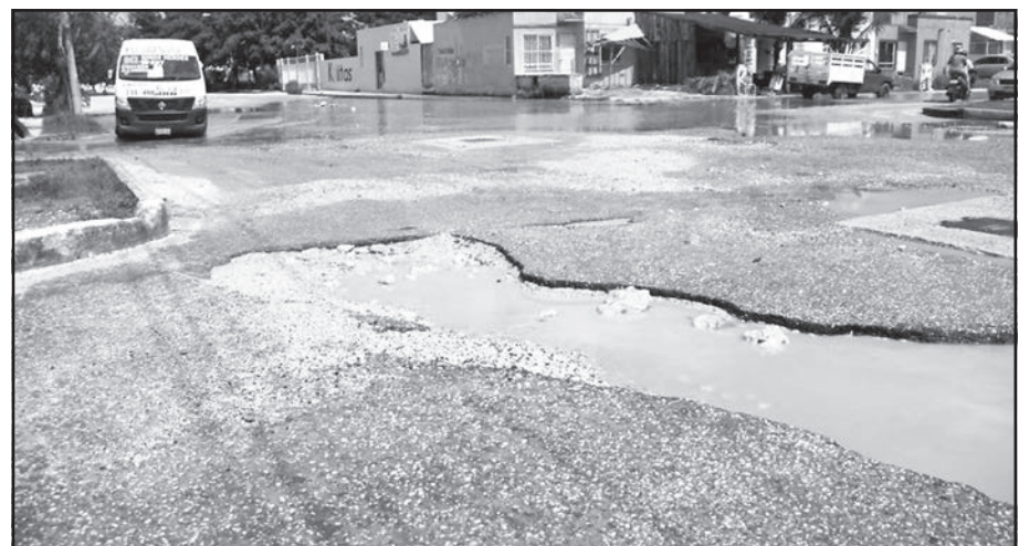
Ciudadanos dijeron que les preocupan los daños durante la fase pluvial. (Fotos POR ESTO!)
