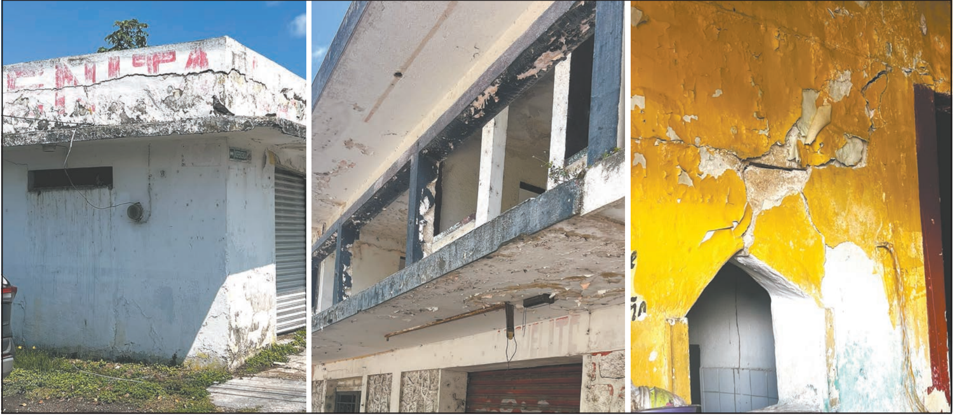
Habitantes del Barrio Mágico exigieron a las autoridades que localice a los propietarios y los obligue a repararlos o derribarlos para evitar un accidente de gravedad. (Fotos E. Martín)
