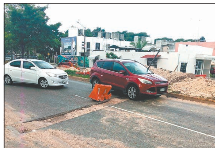
Habitantes de Villas Morelos 2 pidieron cerrar la zanja. (POR ESTO!)
