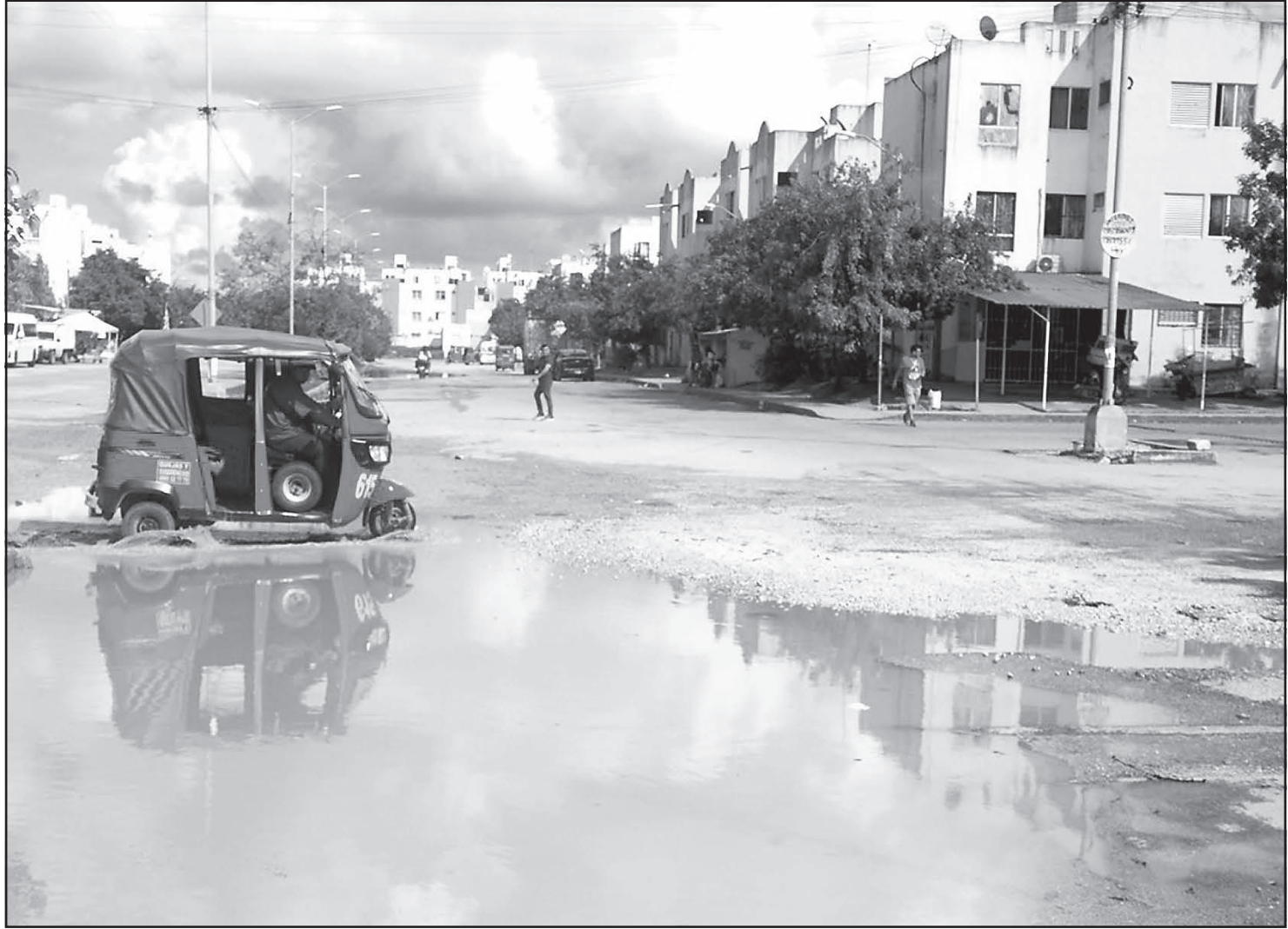
Una de las vialidades más averiadas en la ciudad es la avenida Galaxias del Sol, particularmente en el tramo que conecta las Regiones 255 y 252.
