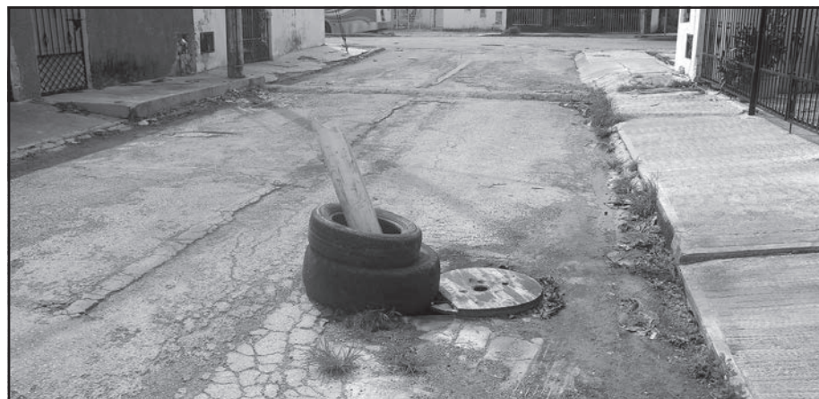
En la vía 95 hace años colapsó el drenaje; el agujero es marcado con diversos objetos.
